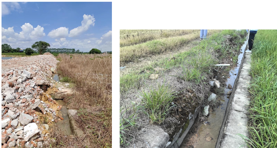
图 3-3 项目损坏的渠道
