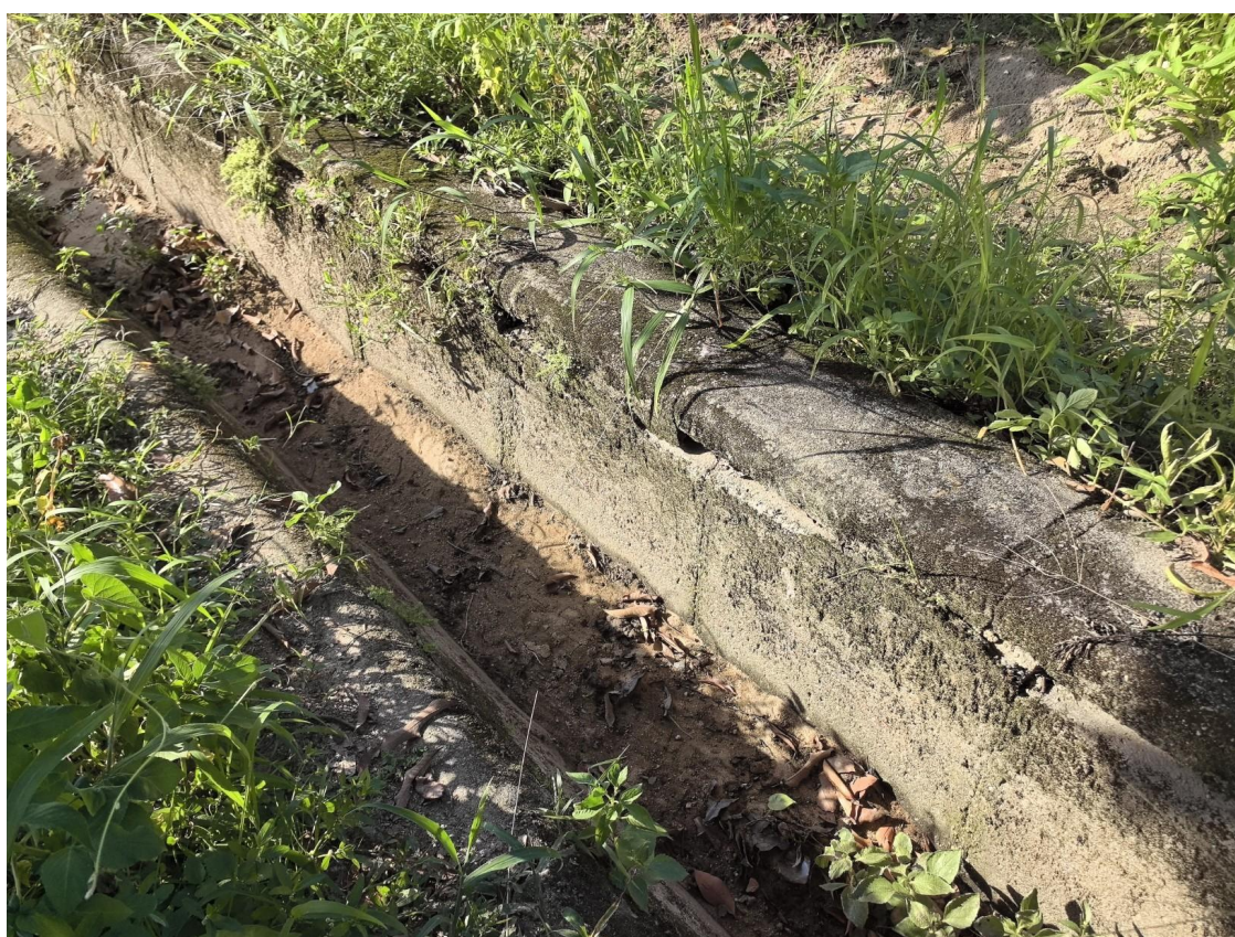
图 2-5 项目漏水严重的 U 型渠道（二）
